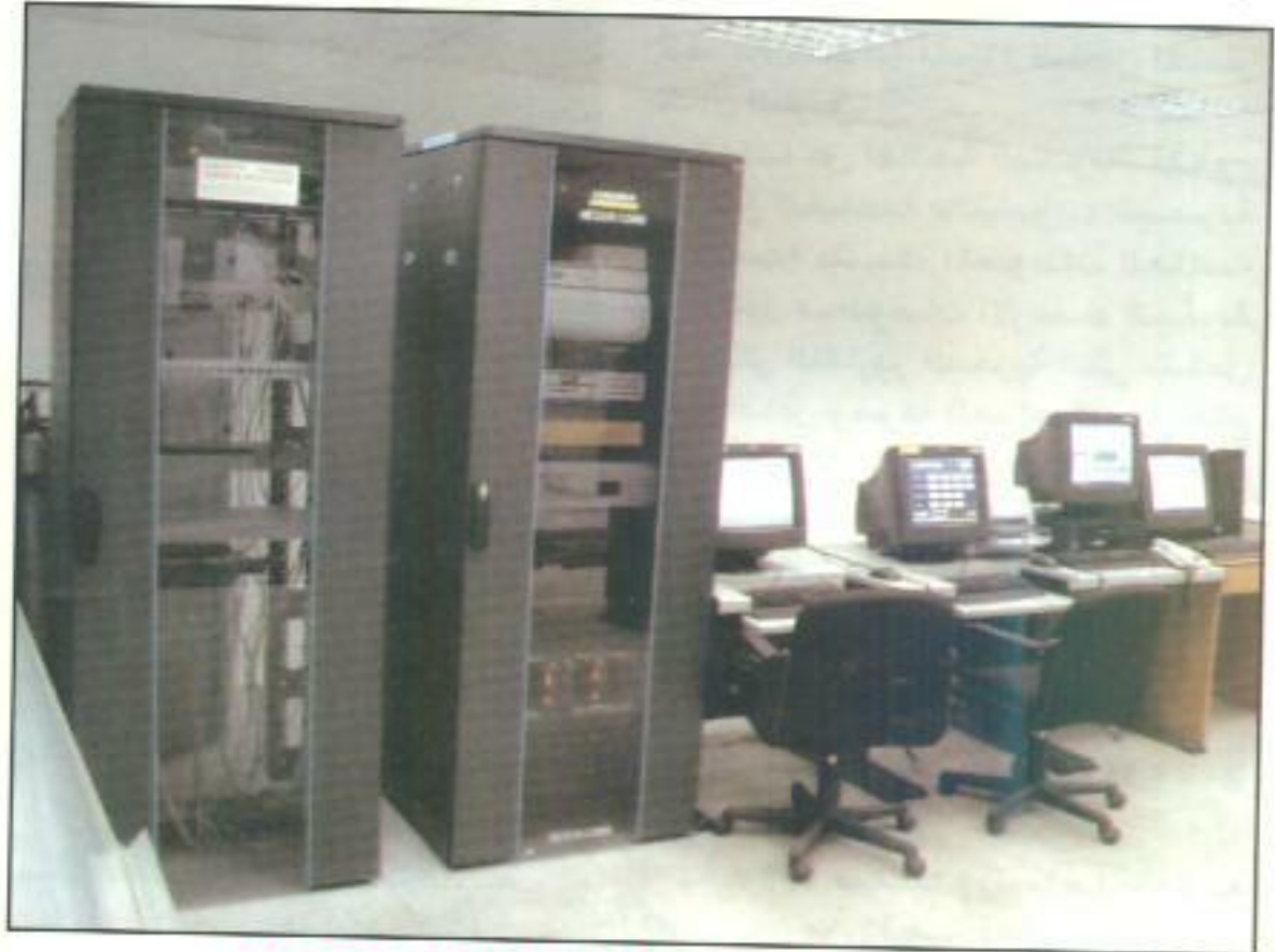
وحدة توزيع بيانات مركز القاهرة الإقليمى للاتصالات
