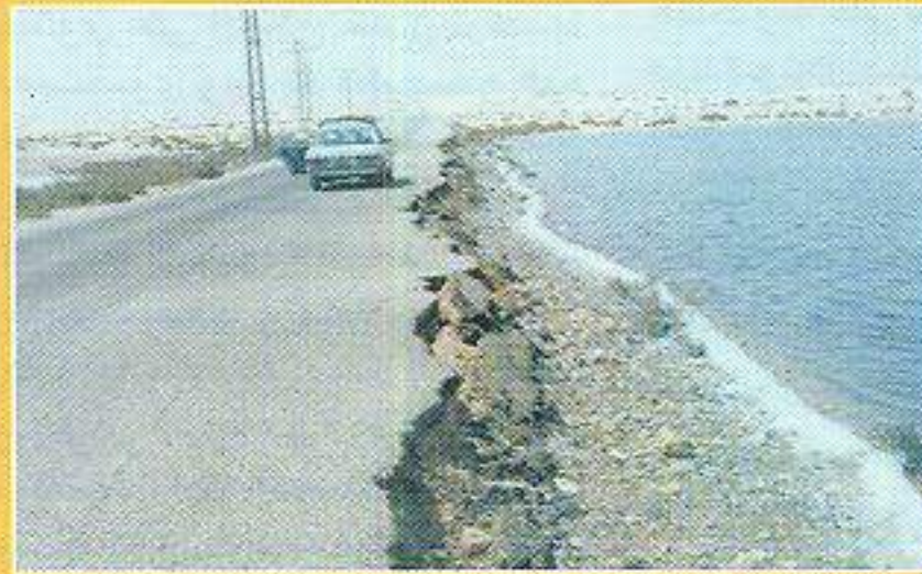
صورة «٦» - انهيار أحد جانبي الطريق بفعل النحت البحري والتجوية الملحية
